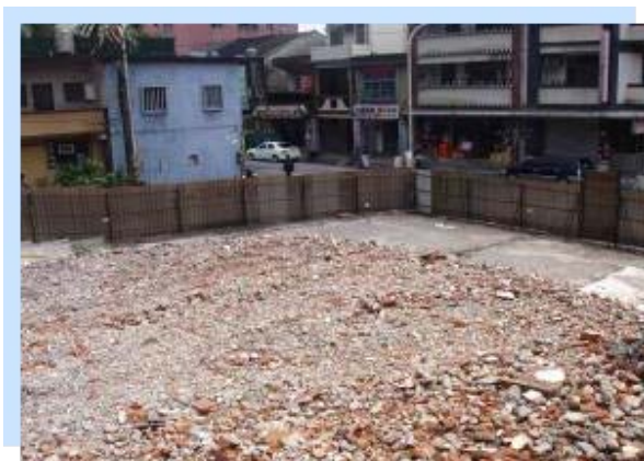
1163、1167 、1156地號 違建拆除
